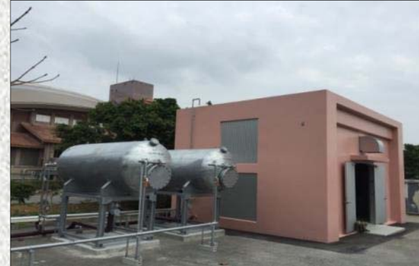
【Gas tank and control room】
