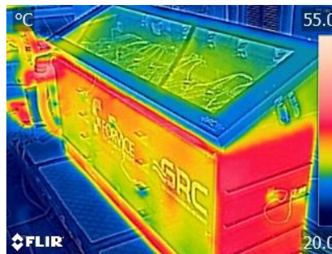
熱画像_液槽正面
