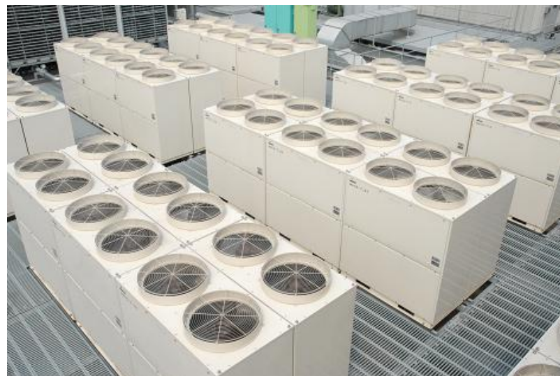
空冷ヒートポンプ屋外機
