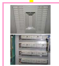
空調等 自動制御設備
