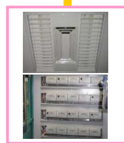
空調等自動制御設備
