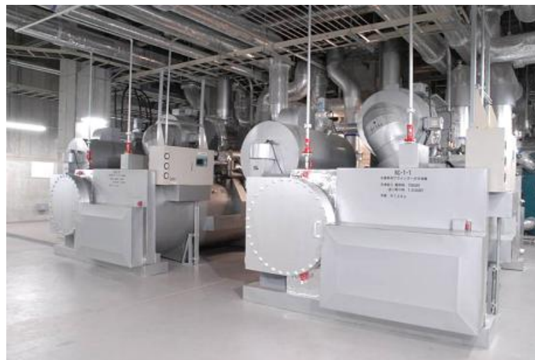
ターボ冷凍機
