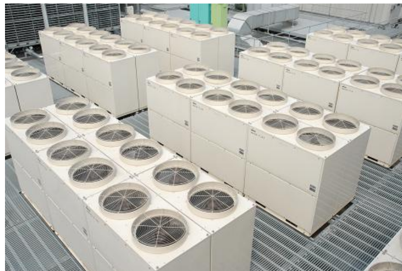
空冷ヒートポンプ屋外機
