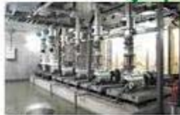
● 中央給・排水ポンプ
