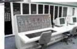
● 中央監視装置
