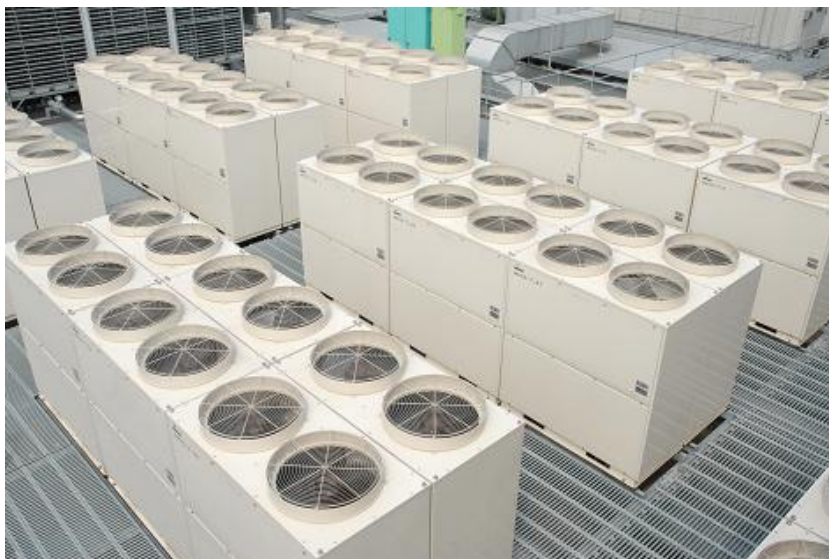
空冷ヒートポンプ屋外機
