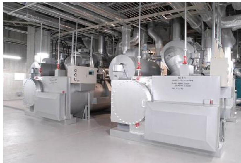
ターボ冷凍機
