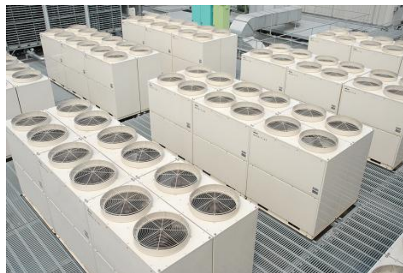
空冷ヒートポンプ屋外機
