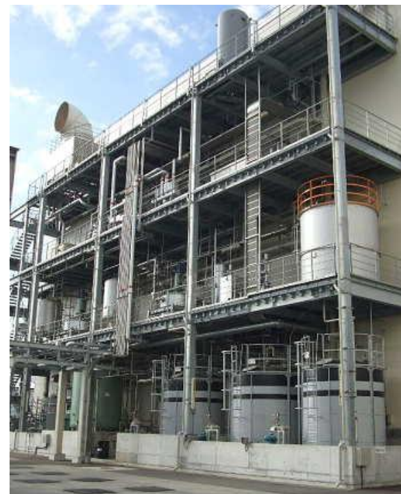
原薬合成工場施工例
