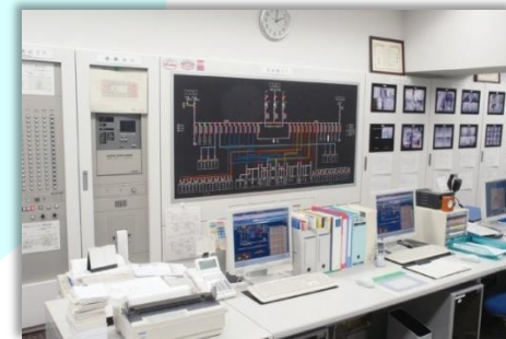
【情報通信設備】
