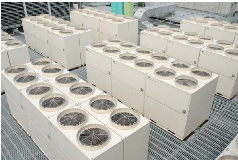
空冷ヒートポンプ屋外機
