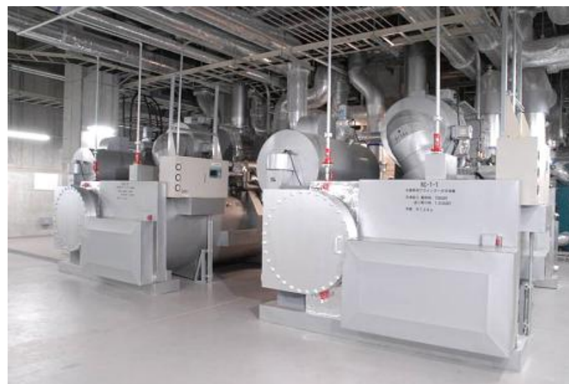
ターボ冷凍機
