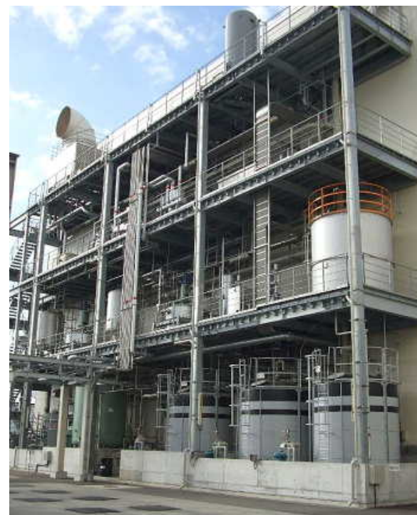
原薬合成工場施工例
