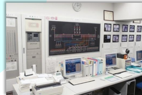
【情報通信設備】
