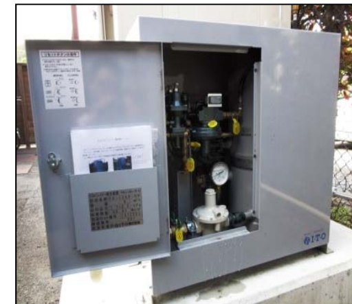
【LPガスを利用したコージェネレーションシステム(制御部分)】
