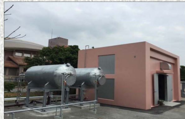
【ガスタンク・制御機器室】
