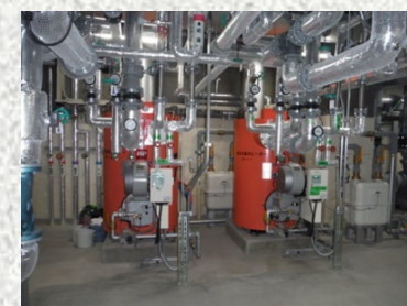
機械室・温室ヒーター
