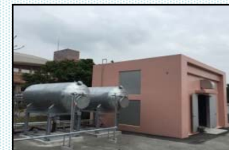
ガスタンク・制御機器室
