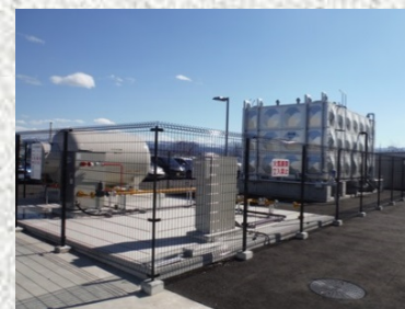
外部受水槽・LPG装置
