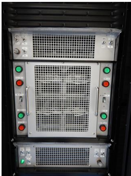
【サーバーラックに収められた模擬発熱体】 (ニッケイ製)
