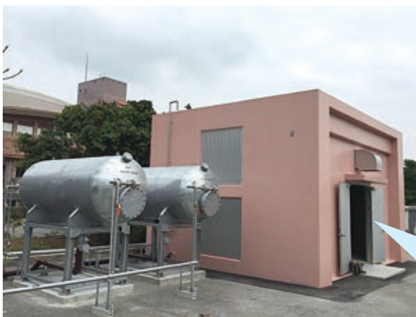
ガスタンク・発電機室
