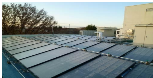
屋上部太陽熱集熱器
