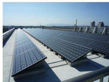
屋上部太陽光発電パネル
