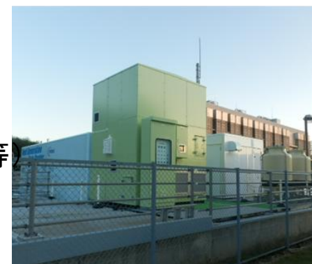
▲モジュール型データセンタの外観
