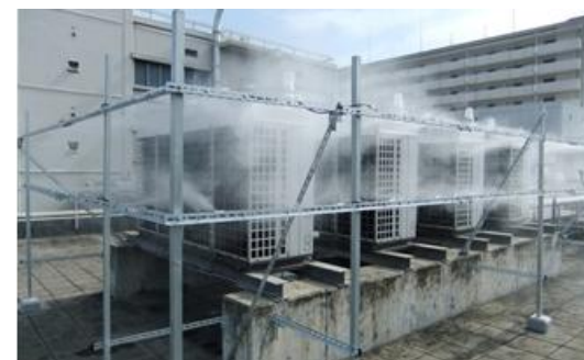
▲空調用屋外機へドライミストを散布
