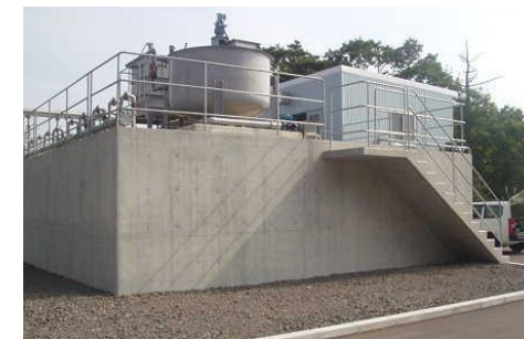
廃水処理施設 施工例
