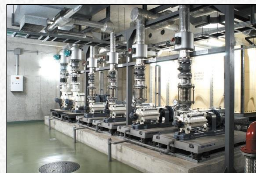
受水槽・揚水ポンプ
