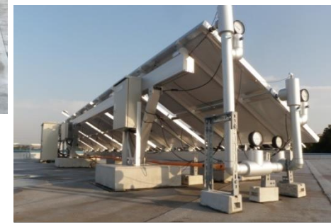
▲太陽光電池パネルの裏面に熱取得装置を搭載
