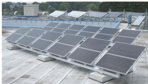
▲太陽光ハイブリッドパネルの外観は太陽光発電パネルと類似
