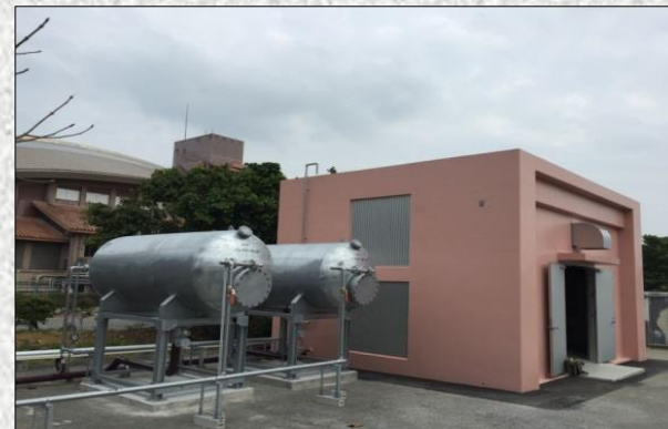
【ガスタンク・制御機器室】
