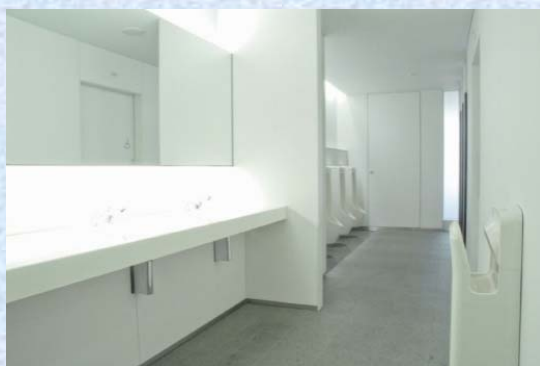
[給排水衛生設備]
