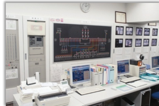
[情報通信設備]
