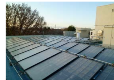
【太陽熱利用システム】
