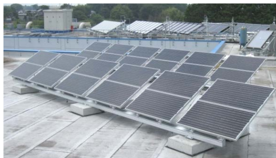
▲太陽光ハイブリッドパネルの外観は太陽光発電パネルと類似
