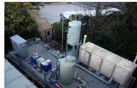
【天然ガス利用コジェネシステム】
