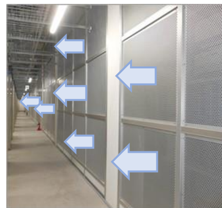
壁面全面から空調空気をサーバーへ供給
