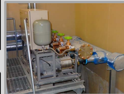
上水加圧給水ポンプ
