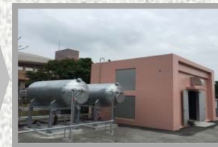
ガスタンク・制御機器室
