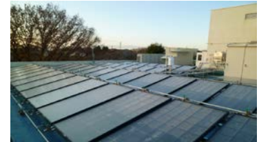
【太陽熱利用システム】
