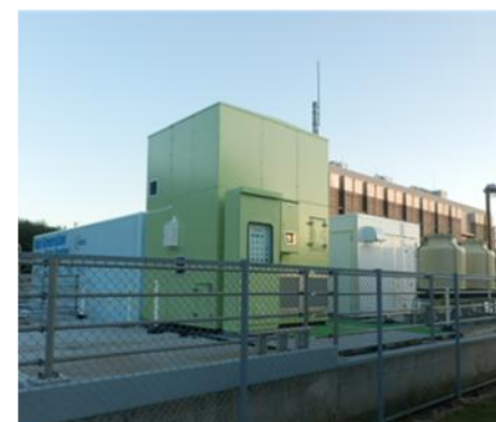
▲モジュール型データセンタの外観
