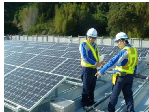
▲NEXCO中日本社の高速道路PA太陽光発電システム
