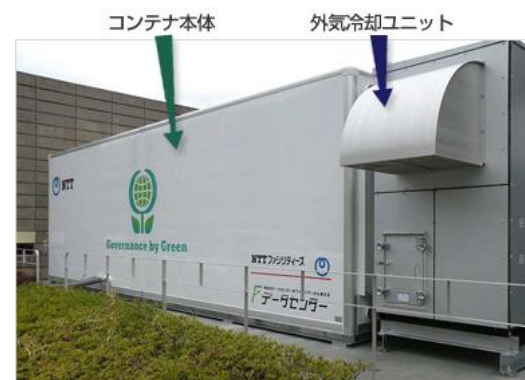
▲コンテナ型データセンター設置例
