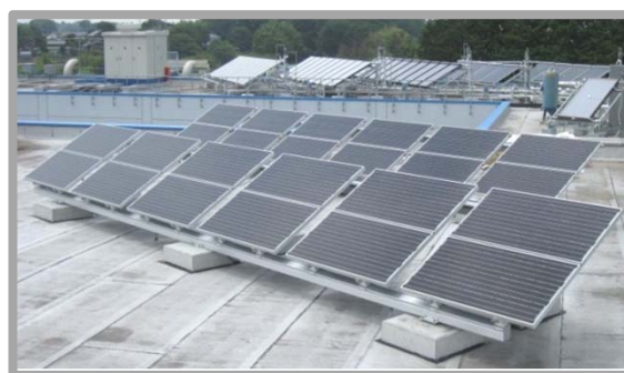
▲太陽光ハイブリッドパネルの外観は太陽光発電パネルと類似
