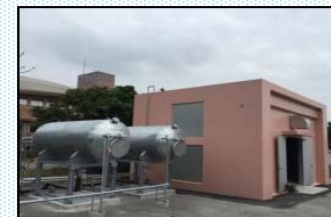
ガスタンク・制御機器室
