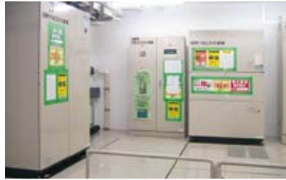
MACS空調機・制御盤
