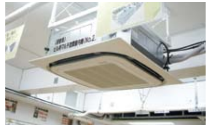
ビル用マルチ型空調機
