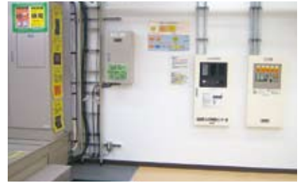
火災受信機・火早期盤
