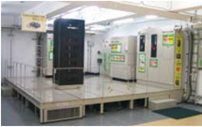
MACS空調機・制御盤・サーバラック
