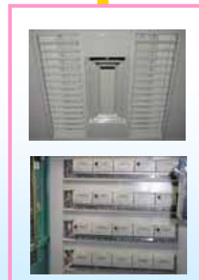
空調等自動制御設備
