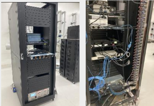
水冷サーバー
