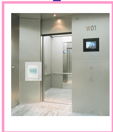
エレベータ 停止階制御
