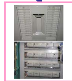
空調等 自動制御設備
